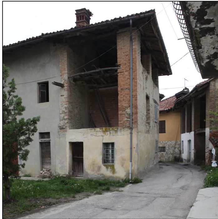
Figura 2: Particolare di un fabbricato fatiscente nella Borgata Valeirano
