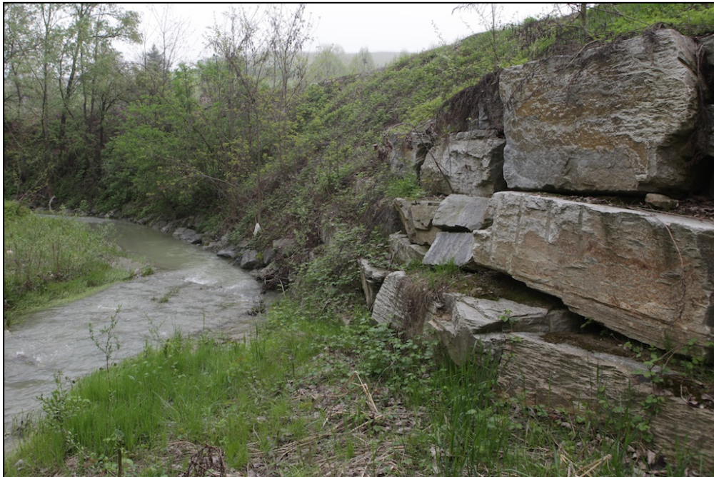
Figura 3: Scogliera a protezione parziale del rilevato vista dal greto del T. Seno d'Elvio.
